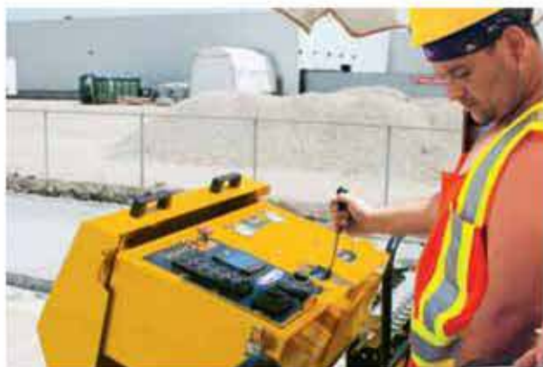
Оператор работает на площадке управления GP2400
