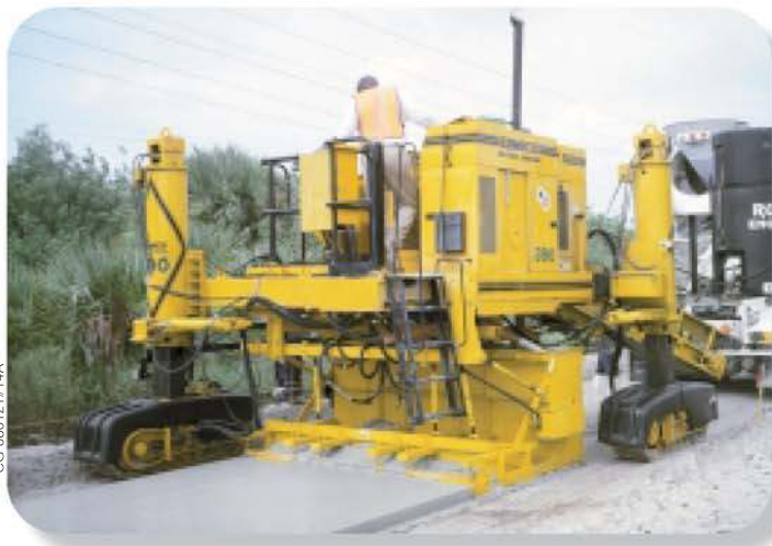
GT-3600 бетонирует тротуар шириной 2,44 м в строительном проекте жилищного комплекса в Иллинойсе.
