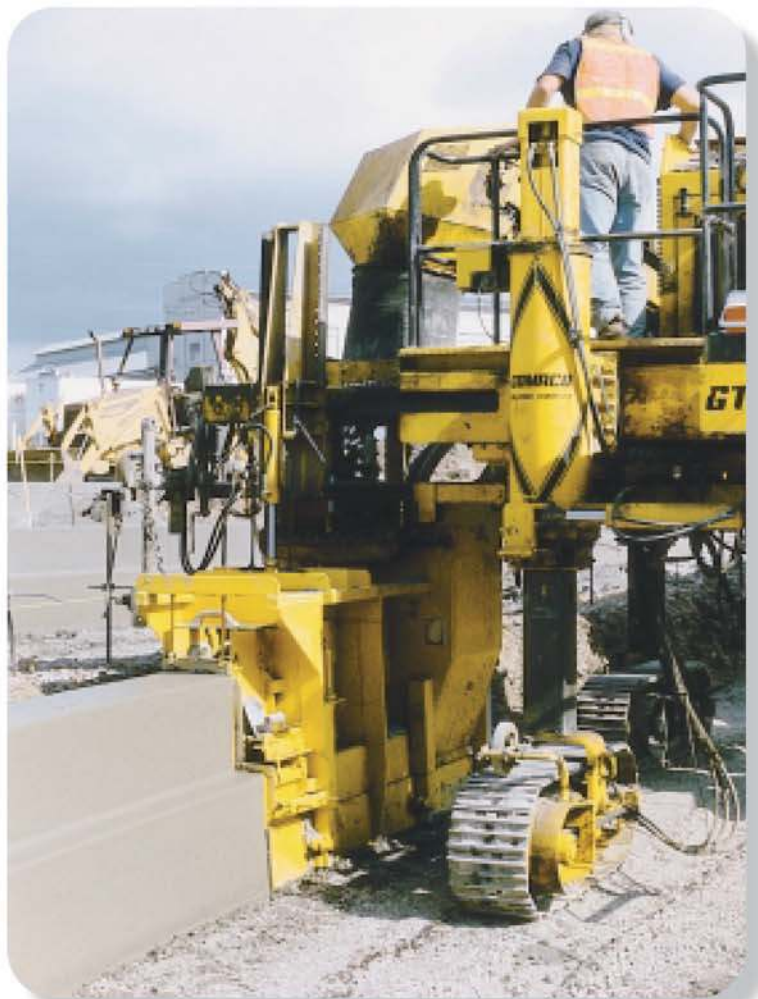
Другой уникальный проект включает в себя террасирование для амфитеатра в Салеме, Орегон. Подпорные стенки были забетонированы с использованием GT-3600 с водостоком/уклоном высотой 864 мм, шириной 152 мм, и имеющим тупой угол наклона.
